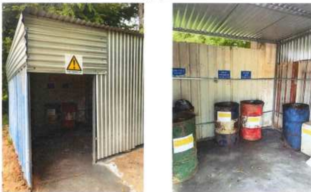
Hình 3.4. Kho chất thải nguy hại tại khu vực mỏ
